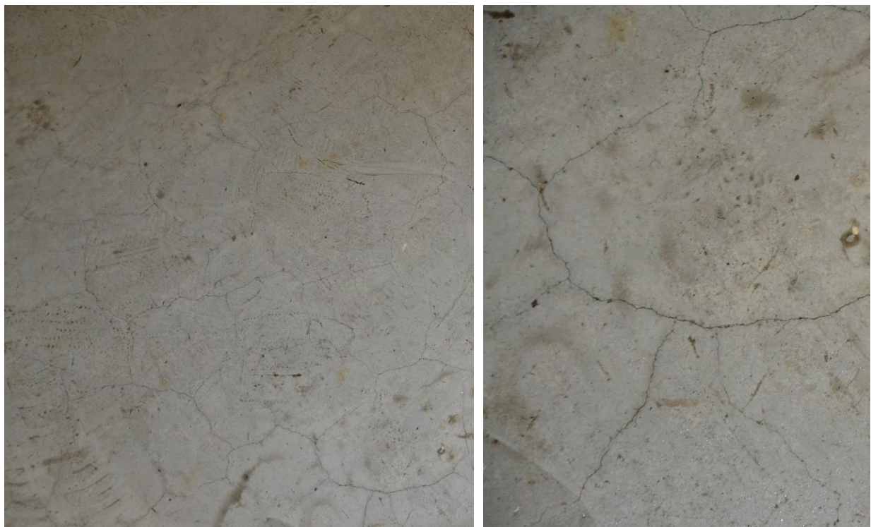
Figur 2.33 Krympsprickor och ytligt slitage efter dubbdäck på Hårdbetong Mastertop efter 7 år på parkeringsdäcket i Åkeshov
