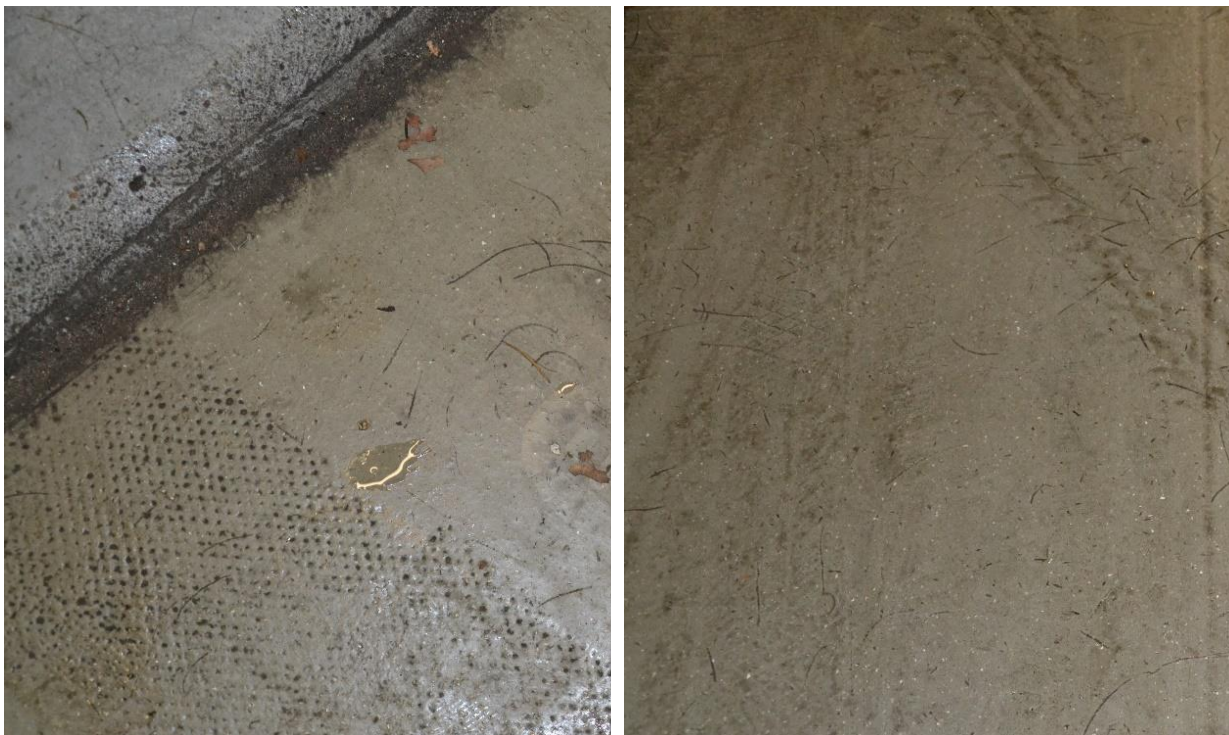
Figur 2.31 Ytligt slitage efter dubbdäck på Polyuretan Ucrete efter 7 år på parkeringsdäcket i Åkeshov
