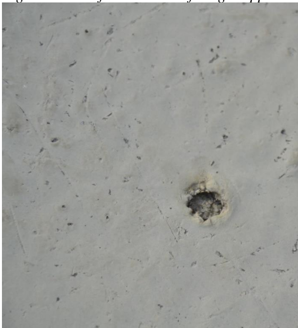
Figur 2.48 Grop i polyurean ner till betongen.
