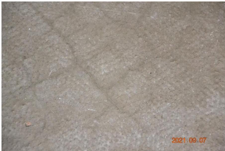
2.5 Ytlig krackelering och krympsprickor noterades
