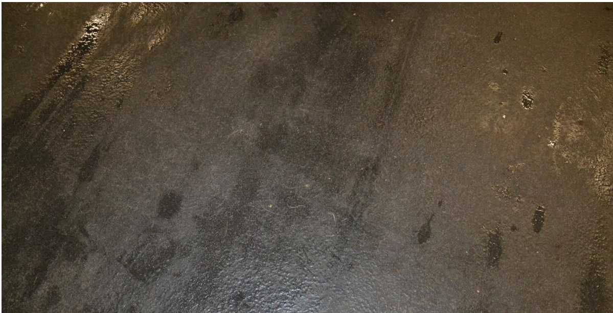
Figur 2.29 Ytligt slitage efter dubbdäck på Akryl Duracon efter 7 år på parkeringsdäcket i Åkeshov
