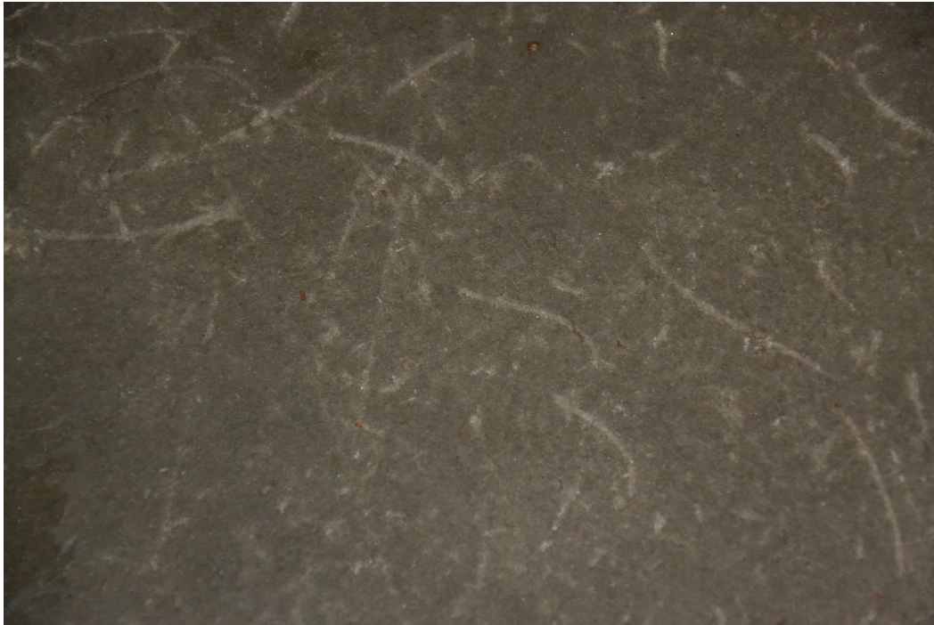
Figur 2.24 Hårdbetong Intercrete på parkeringsdäcket i Åkeshov 2021
