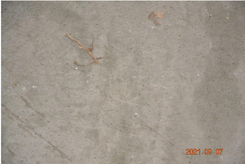
Figur 2.7 Polyuretan Sikafloor på parkeringsdäcket i Kville 2021
