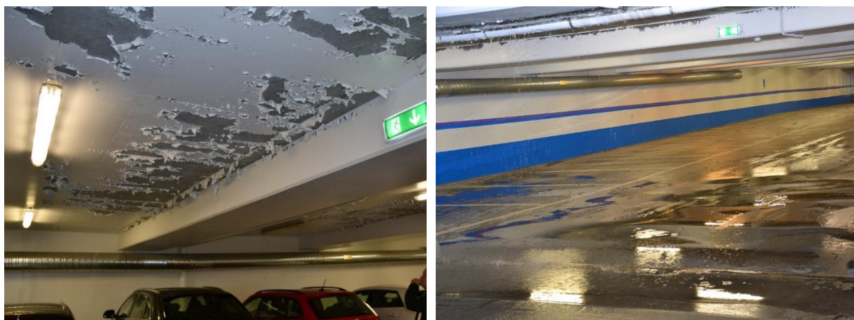
Figur 2.21 Det nymålade taket i parkeringsgaraget i Åkeshov 2019 (tv). Kraftigt läckage i samma tak 2021 (th)
