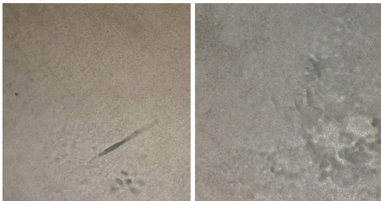
Figur 2.18 Gropar och ytligt slitage efter dubbdäck på Polyurea Micorea S3 efter 8 år på parkeringsdäcket i Kville
