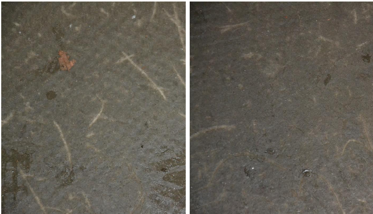
Figur 2.25 Ytligt slitage från dubbdäck på Hårdbetong Intercrete efter 7 år på parkeringsdäcket i Åkeshov
