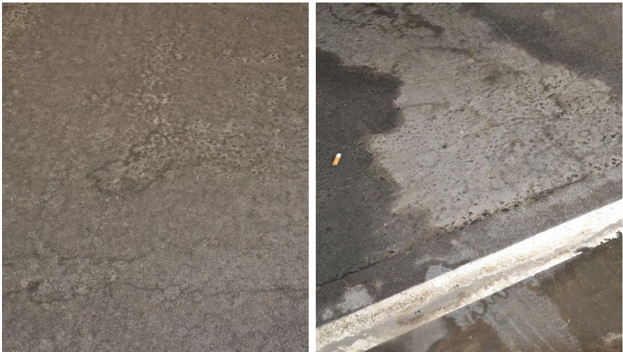
Figur 2.4 Vissa defekter i provytans kanter noterades
