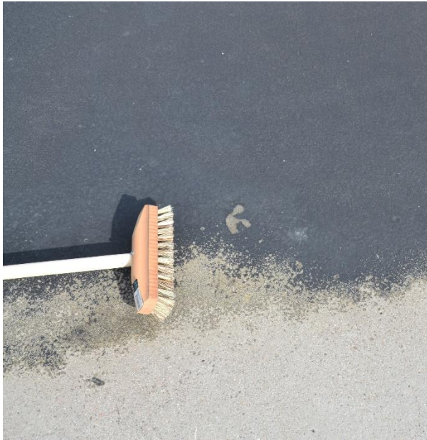
Figur 2.39 Visst slitage i kanter, övergång mot betong
