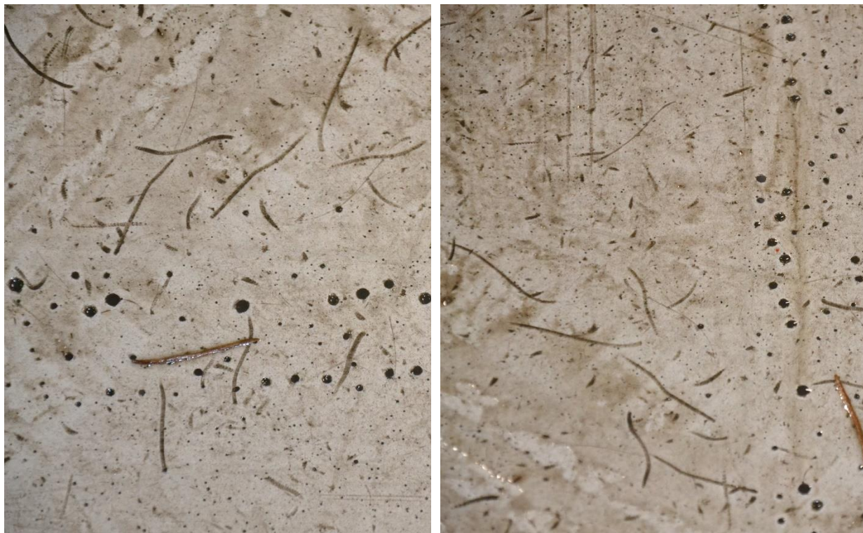
Figur 2.35 Ytligt slitage efter dubbdäck och blåsor/gropar på Epoxi Micopox efter 7 år på parkeringsdäcket Åkeshov
