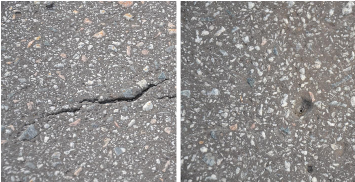
Figur 2.45 Gjutasfalt PGJA 11 efter 6 år på parkeringsdäcket i Baggen 2021. Sprickbildning i bomparti samt grop/stensläpp
