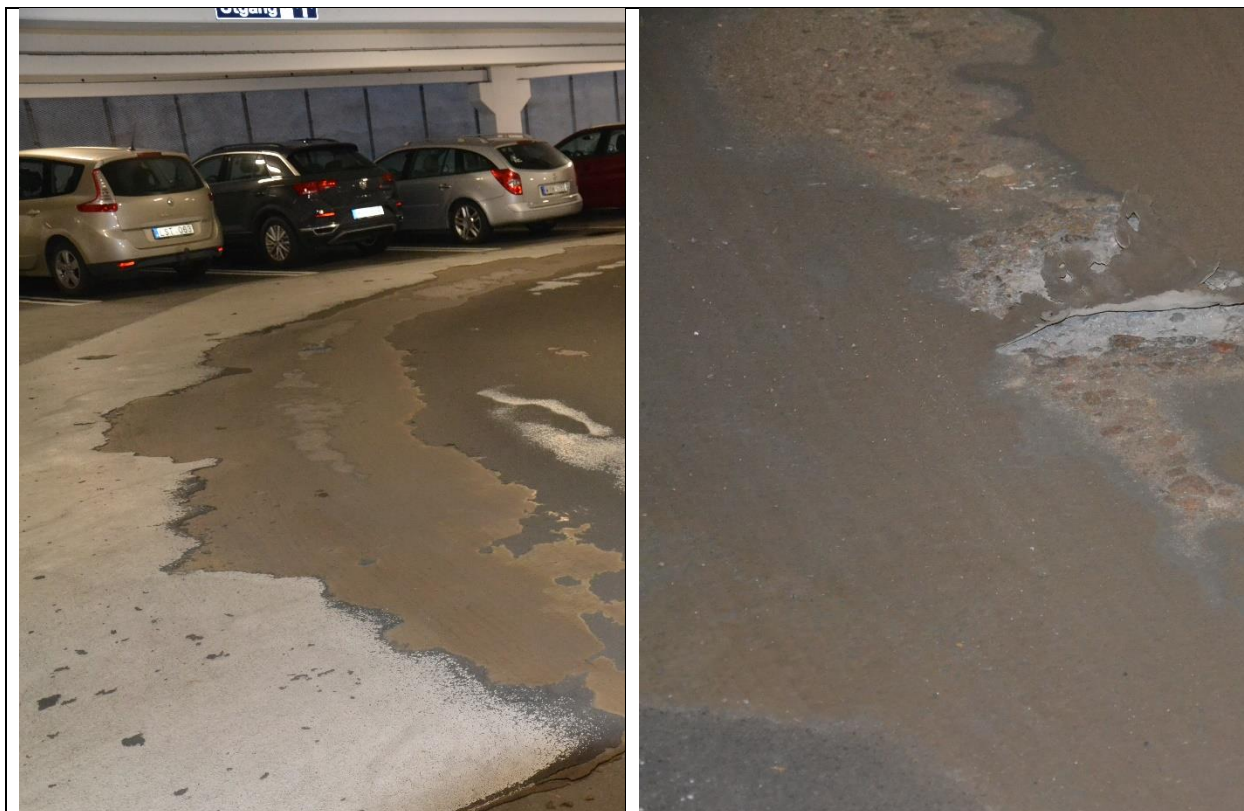
Figur 1.1 Betongskador i garage - Olämpligt val av beläggningssystem. Foto: Ylva Edwards
